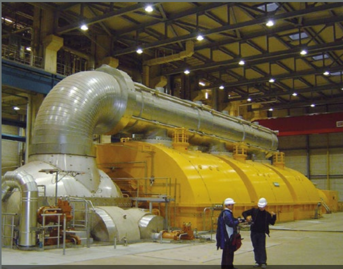
스프링 방진시스템이 적용된 900MW 지멘스 터빈, 독일
